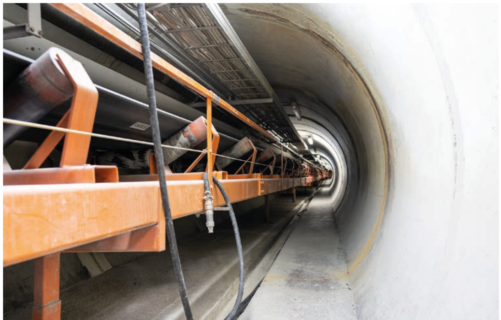
Durch diesen Tunnel unter dem Alpenquai wird fast alles Rohmaterial für den Betonbau ins Werk an der Landenbergstrasse transportiert. Der fertige Beton wird später per LKW an die Baustellen ausgeliefert. Weitere Bilder gibt es auf der Homepage des Quartiervereins.
